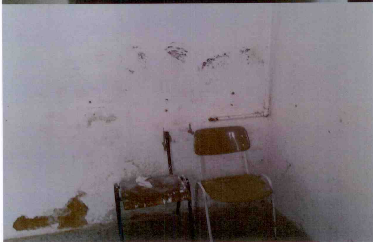
Neutěšený stav toalet a zdi před ní
